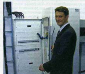
Павел Пека демонстрирует шкафы автоматики в башне «Запад»
